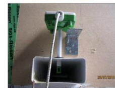
Figure 4: Montaggio anemometro sistema di ventilazione.
